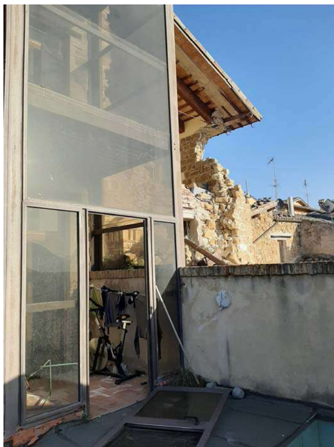
Foto 9 – Particolare interno del crollo del timpano ala Est
