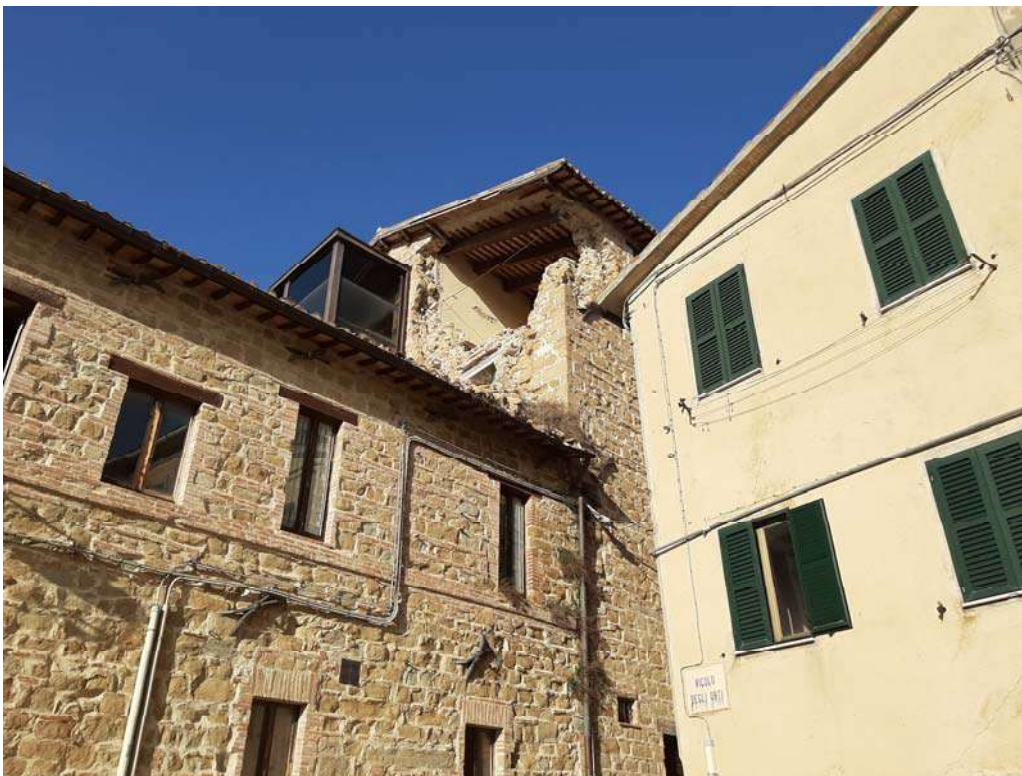
Foto 3 – Particolare timpano ala est crollato (lato monti)
