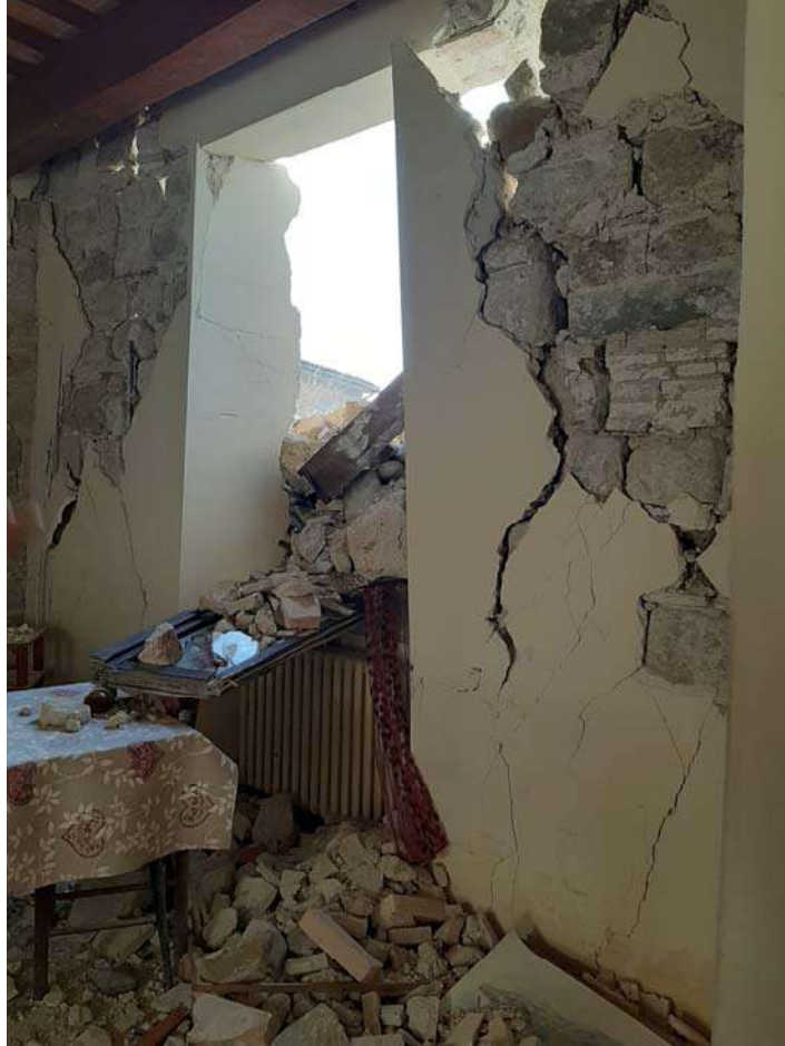
Foto 7 – Particolare interno del crollo del timpano ala Est
