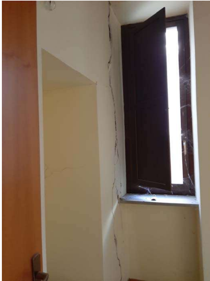
Foto 10 – Particolare delle lesioni su murature portanti
