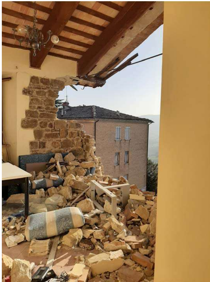
Foto 8 – Particolare interno del crollo del timpano ala Est
