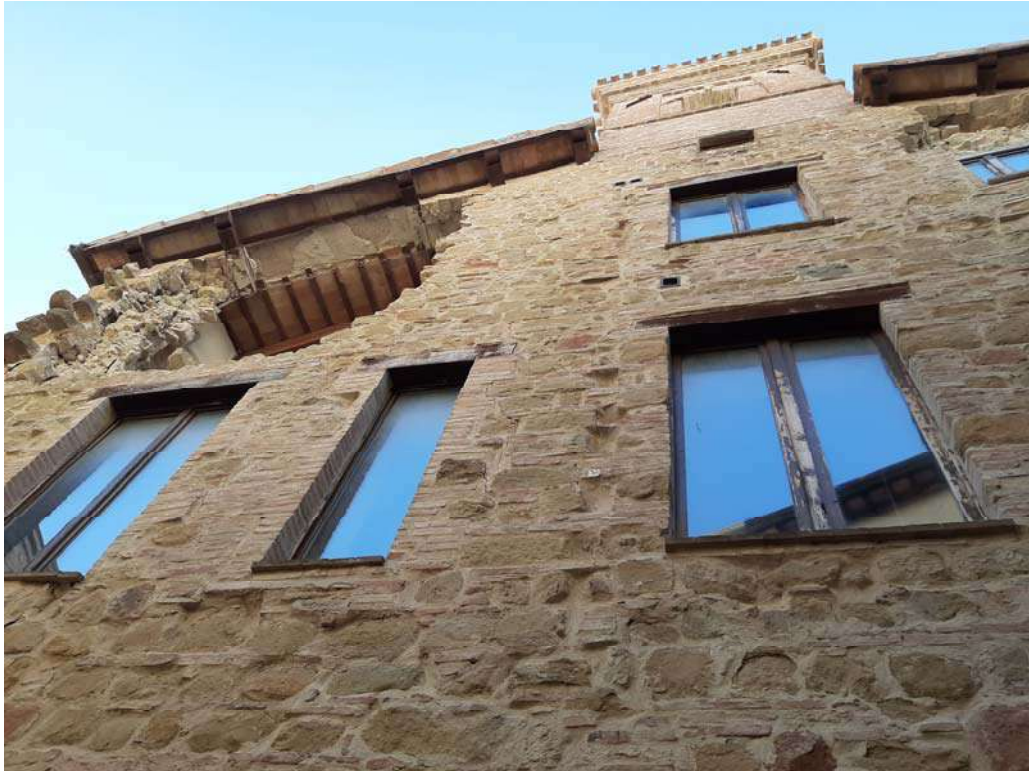
Foto 4 – Particolare timpano ala est crollato (lato centro storico)
