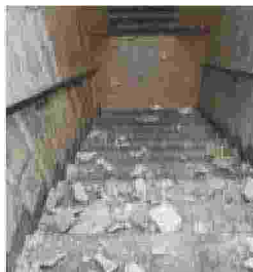
Alcuni calcinacci caduti dopo il sisma
