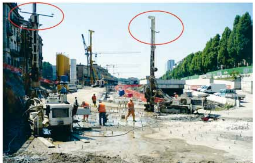
Figura 17 - Sonde con evidenziate le antenne del sistema di posizionamento GPS
