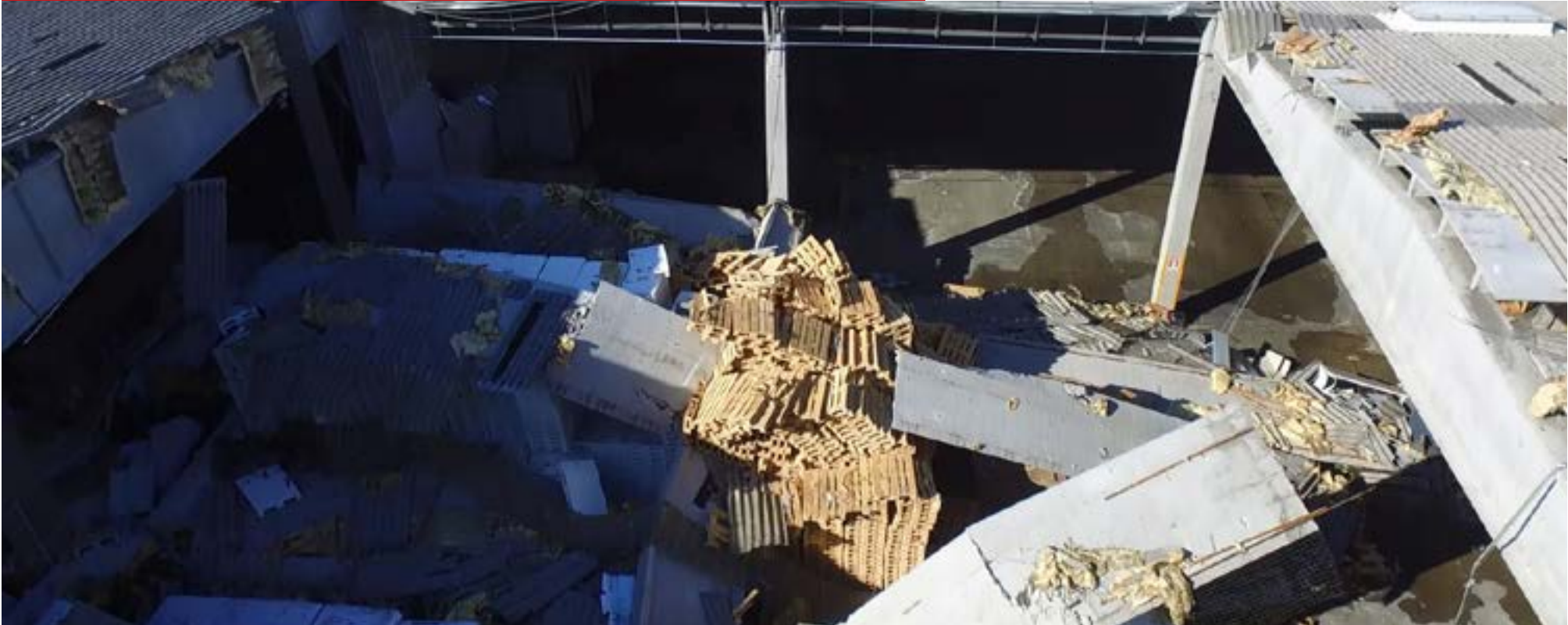
Foto 1. La porzione di copertura crollata
