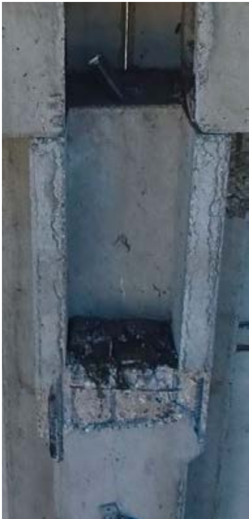
Foto 2. Capitello con crosta di cls che ha ceduto
