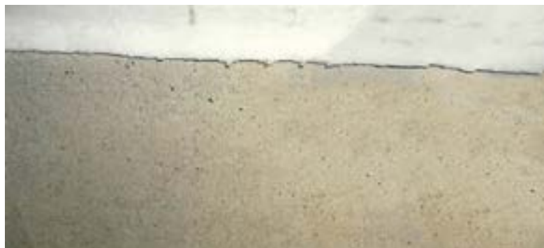
Particolare protettivo al termine della prova
