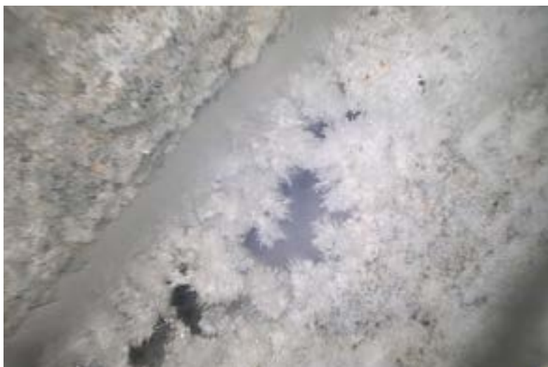
Immagine al microscopio della cristallizzazione in una fessurazione del calcestruzzo
