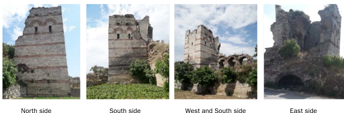
Figura 4 - Viste della torre 19 delle mura di Costantinopoli con visibili i danni causati dal terremoto del 1999, avvenuto poco dopo l'ultimazione dei lavori di restauro del monumento (Flora, 2022).
