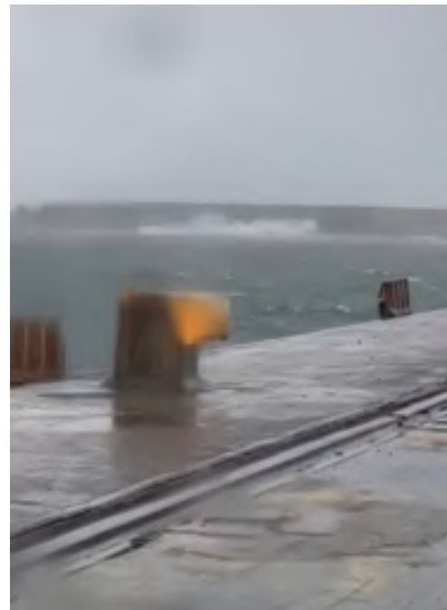
Figura2. Banchina portuale durante una mareggiata. Sullo sfondo la diga foranea danneggiata, con varchi che consentono al moto ondoso di penetrare nel bacino e di compromettere l'operatività della banchina. È il caso concreto in cui il degrado dell'opera di protezione si traduce in perdita di funzione di parte del sistema portuale (Foto: M. Calabrese).
