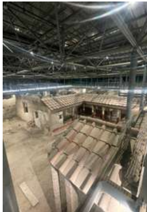
Figura 4. Vista delle coperture dell'Insula dei Casti Amanti, recentemente realizzate a protezione dello scavo, con una passerella sospesa per consentire la visita ai turisti durante i lavori di restauro.
